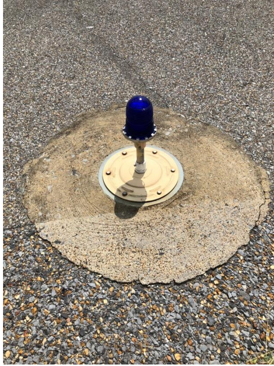
Edge Light (existing)
